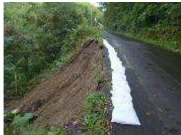
千歳川沿いの斜面崩落。電柱が倒れ支笏湖温泉地区が一時停電。
