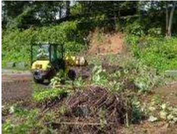
法面が崩落した支笏湖第5駐車場
